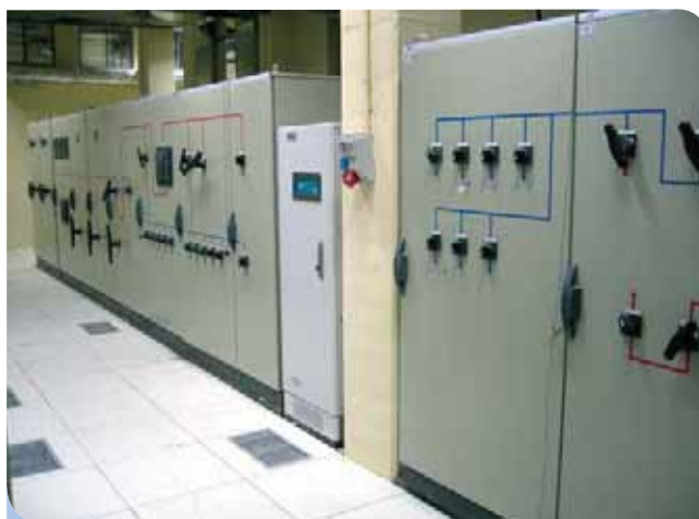
Cuadros de protección y distribución eléctrica con el conmutador estático de transferencia Cross de 250 Amperios
