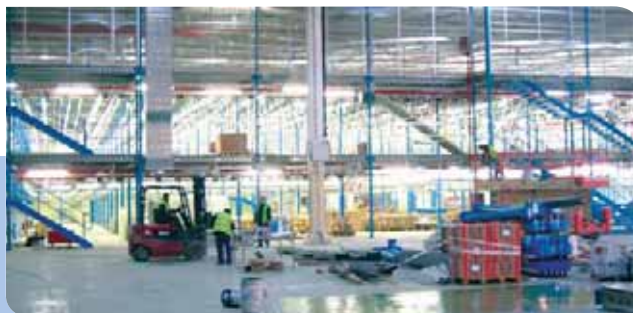
Obras del futuro almacén automatizado, cuyo sistema de control será protegido con un SAI 70-NET de 40 kVA
