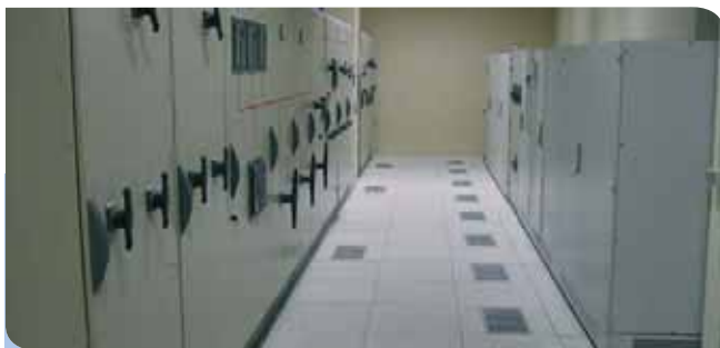
Detalle cuadros de protección eléctrica, SAIs (2 90-NET de 600 kVA) y COC.
