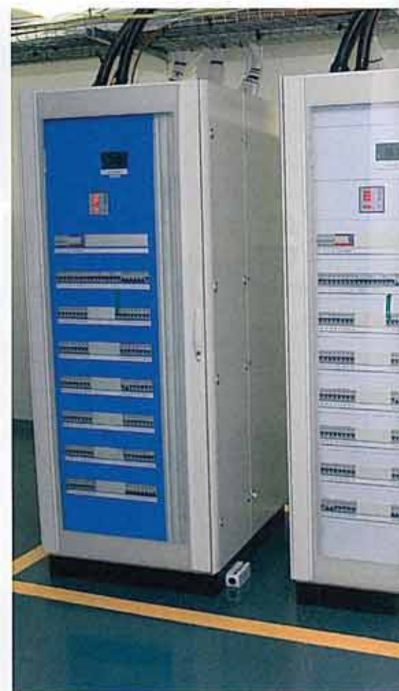
Gli Ups devono essere dimensionati in funzione delle reali esigenze degli utenti.
